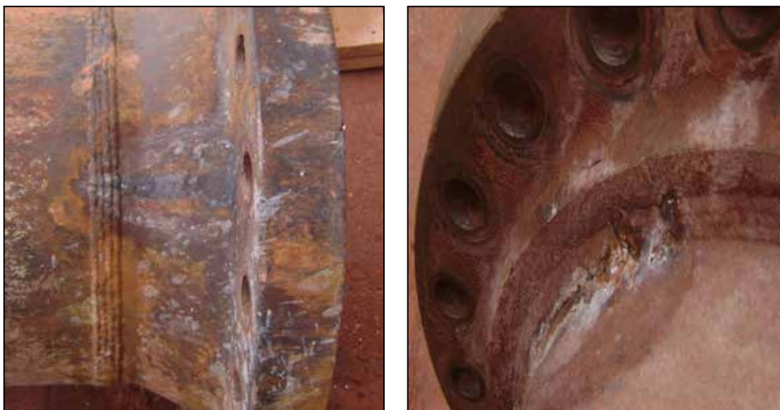
Figura 2.9 – Trincas em tubulação de aço carbono, linhas de licor pobre da área 04A da Hydro-Alunorte.
